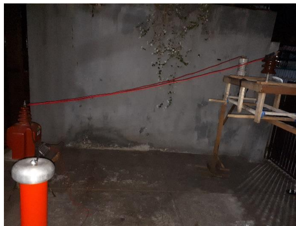
Gambar 5. Pengukuran Isolator post epoxy resin dan pin porcelain
