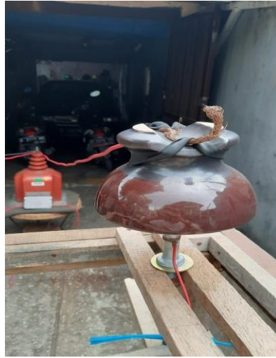
Gambar 2. Isolator Pin Porcelain Saat Dilakukan Pengukuran Arus Bocor
