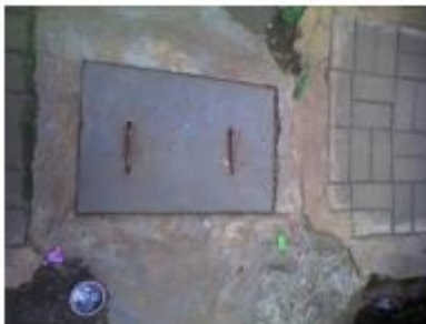
a. tangki kontrol sistem komunal
