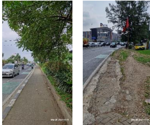
Gambar 2 Kondisi Jalur Pejalan Kaki
