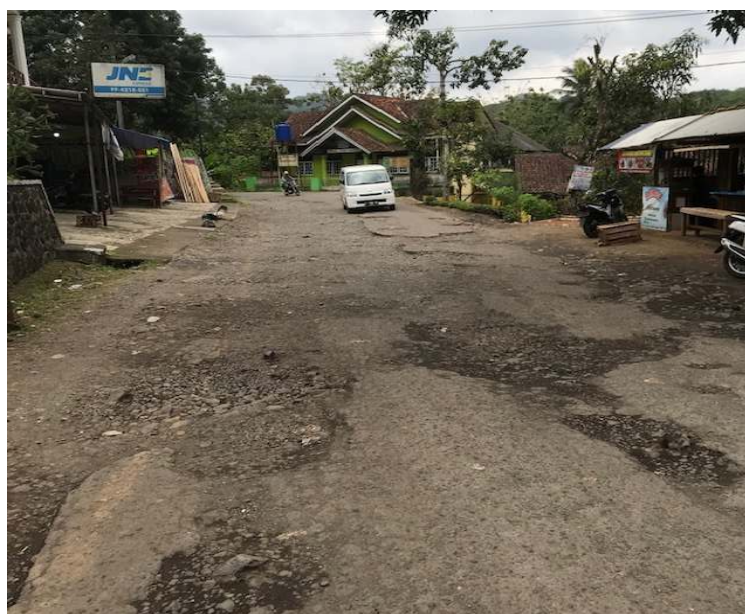
Gambar 3. Kondisi perkerasan Jalan Salopa segmen 1 (Sumber: Foto survey, 2021)
